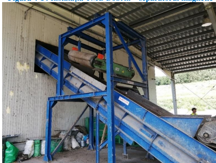
Figura 4-14 Instalația TMB Dobrin – separatorul magnetic
