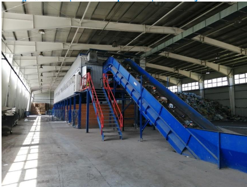
Figura 4-11 Stația de sortare pentru deșeurile menajere Dobrin
