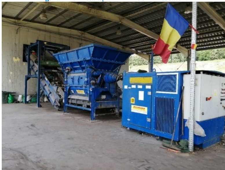
Figura 4-13 Instalația TMB Dobrin - tocătorul
